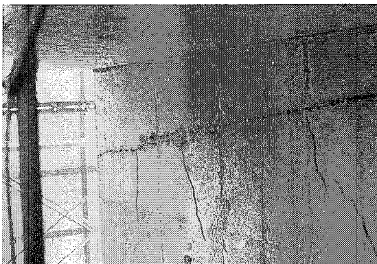
〔写真2〕 躯体コンクリートのコールドジョイント
